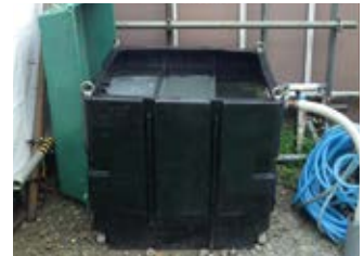
現場に設置するノッチタンク
