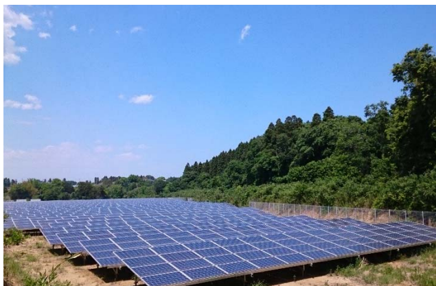
大和茨城第二発電所
