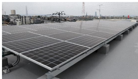
太陽光発電システム
